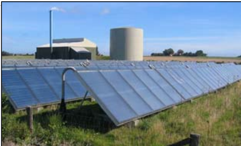
Sol- og bioenergi varmer boliger på Samsø. (Foto: Samsø Miljø- og Energikontor)
